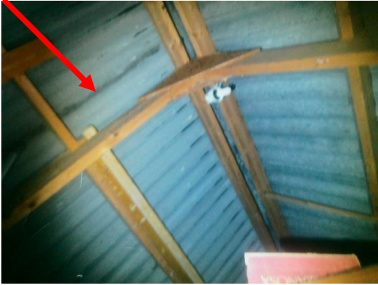
Foto 27 | Golflaten op het dak
